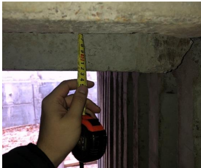
Рисунок 5 – Відмова верхнього блока (ВБ) на ПК0+025
