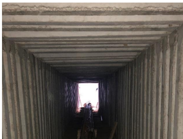
Рисунок 3 – Нерівномірне зміщення елементів покрівлі конструкції
