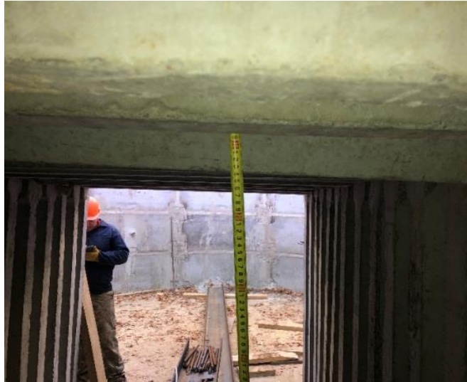
Рисунок 4 – Зміщення елемента конструкції понад 80 мм
