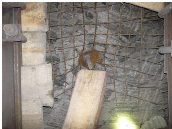
Рис. 6. Деформация шайб анкера в правосторонней части выработки
