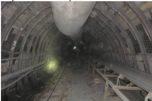
Рис. 4. Состояние выработки в районе ПК 78
