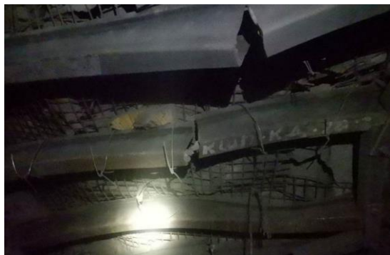
Рисунок 7 – Локальна деформація конвеєрного штреку на етапі підтримання в зоні опорного тиску перед очисним вибоєм.
